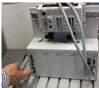
Figura 1A Interruptor de encendido del PLC.
