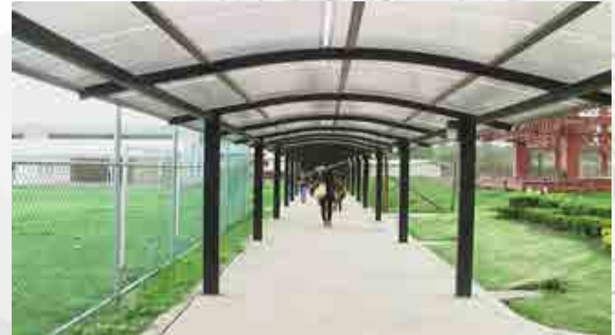
Construcción de andador de la entrada al edificio de Ingeniería Bioquímica en Zacatenco
