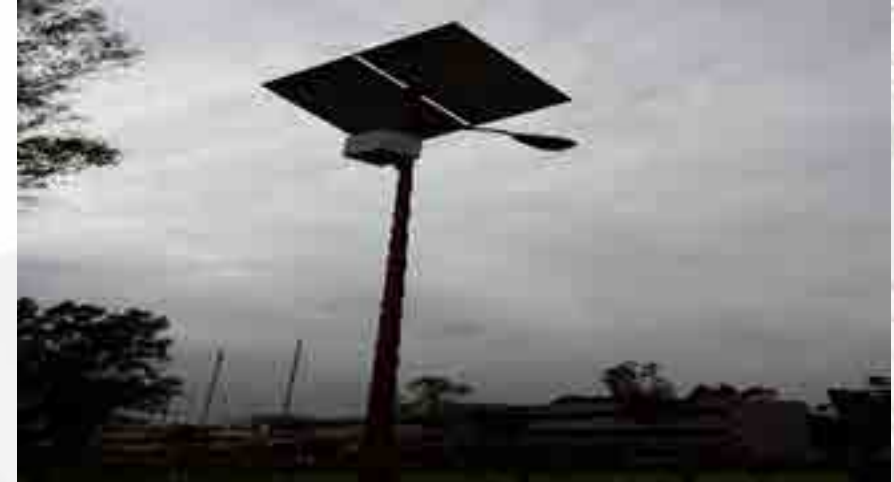
Montaje y colocación de luminarias solares en las instalaciones de la cancha de la ENMH.
