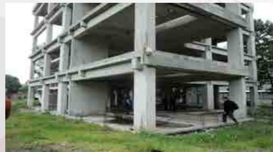
Vista de la construcción del nuevo edificio de aulas en la primera etapa
