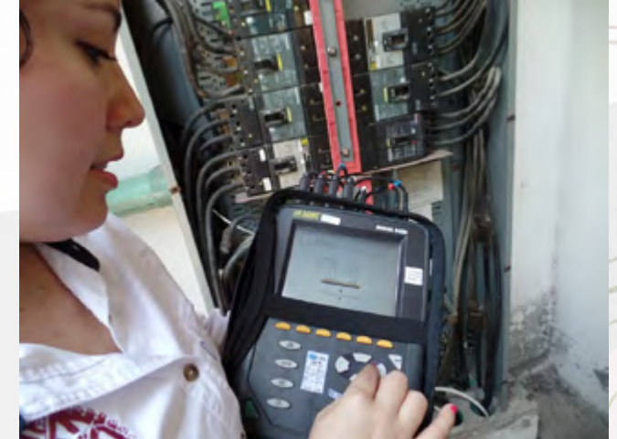
Programación de equipo de redes para la medición de tablero de control eléctrico en una de las escuelas
