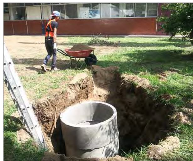
Canalización y entubamiento del agua de lluvia (arriba) y pozo de absorción para la captación de las aguas residuales mediante la infiltración (abajo)
