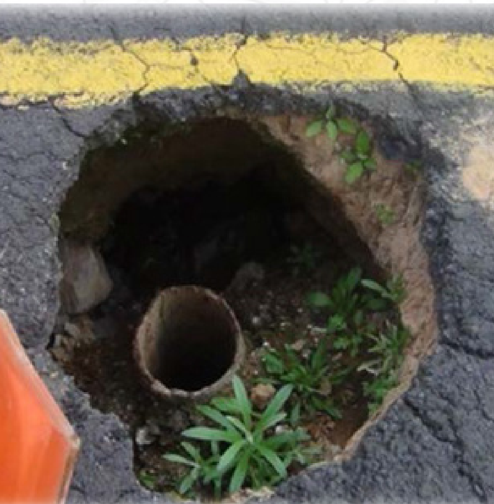
Socavón área de estacionamiento
