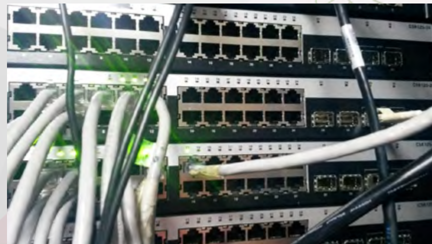
Primer servidor con IPV6 en el centro de datos
