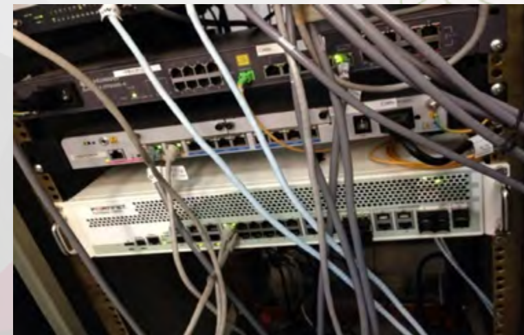
Sistema de Seguridad Perimetral
