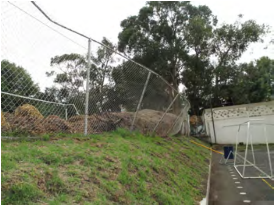
Malla en mal estado
