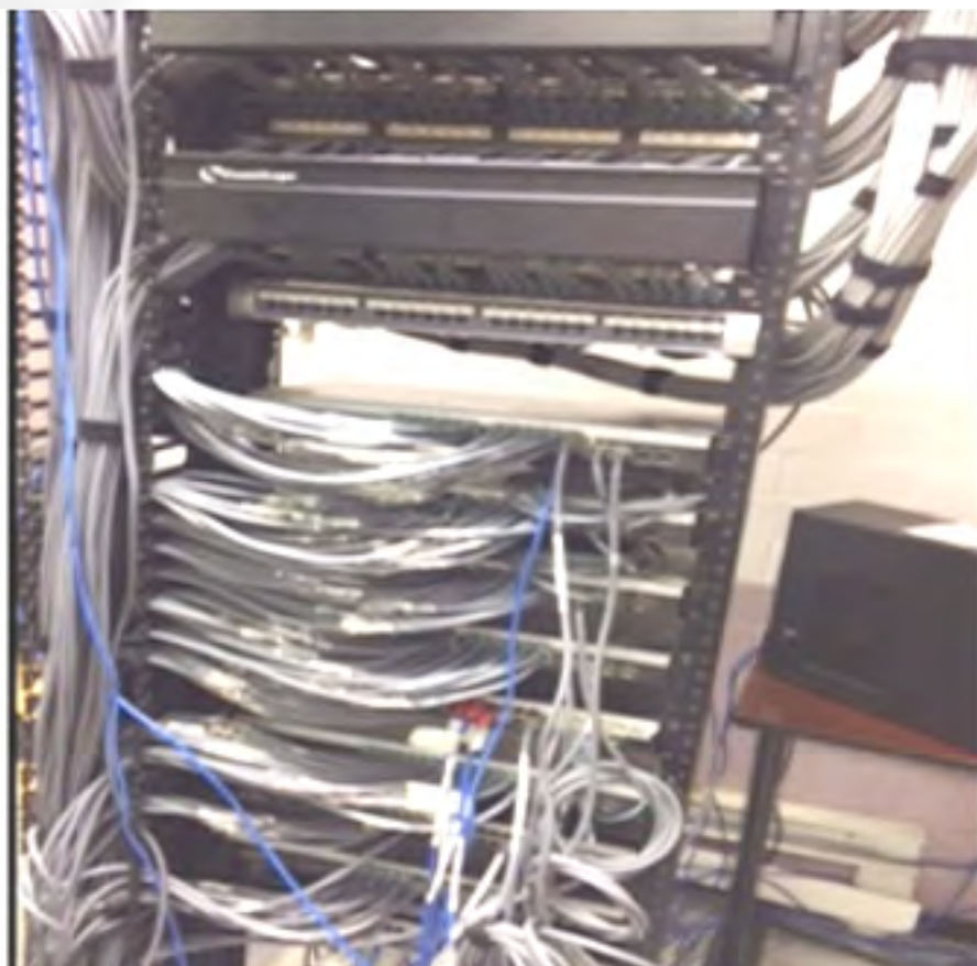
Peinado y etiquetado de cables
