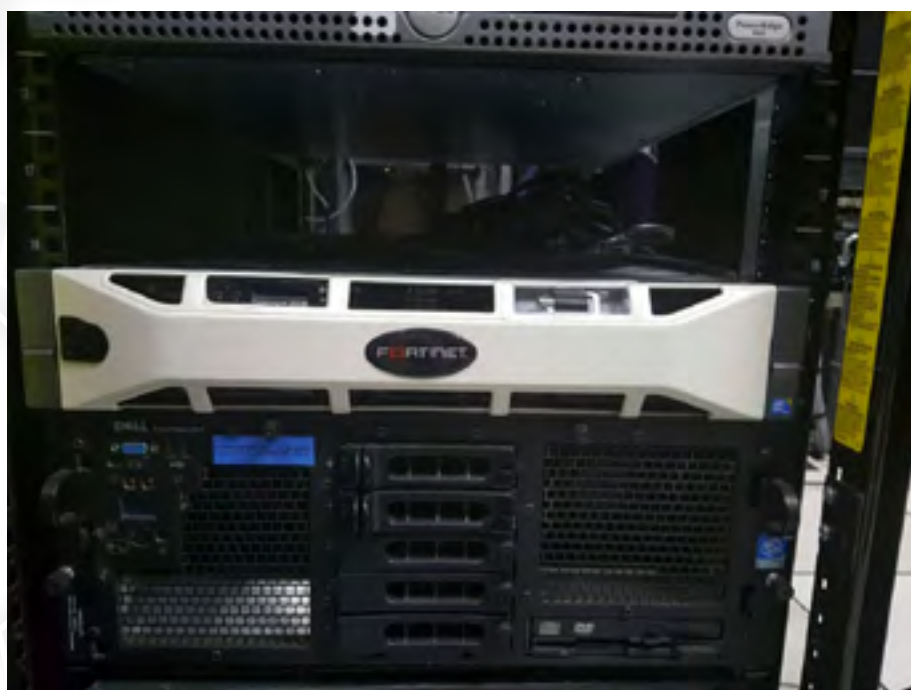
Seguridad perimetral Centros Foráneos
