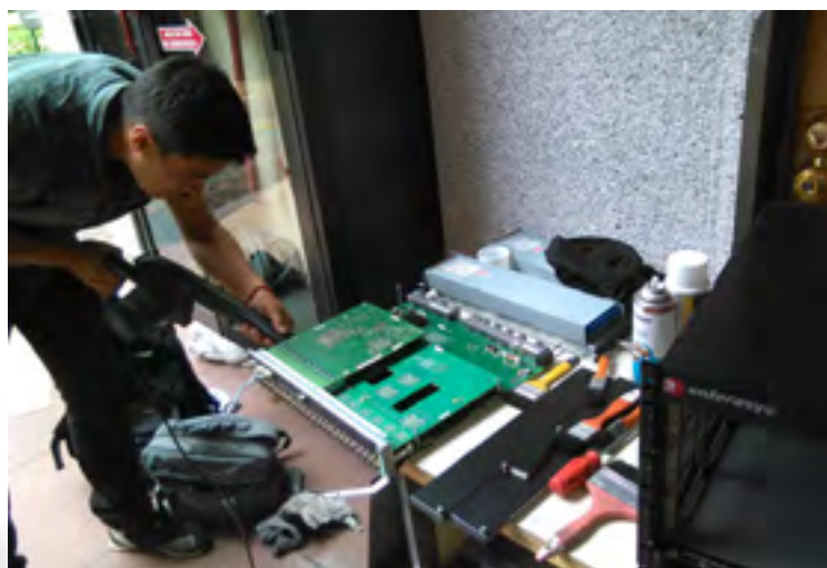
Mantenimiento preventivo a equipo de comunicaciones
