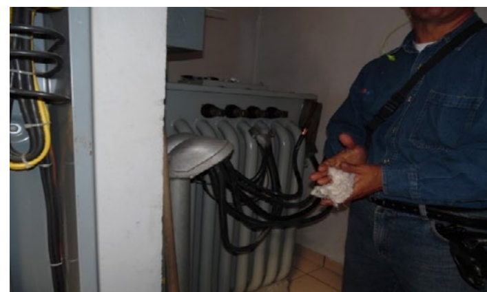
Mantenimiento preventivo y correctivo: Pruebas a subestación eléctrica
