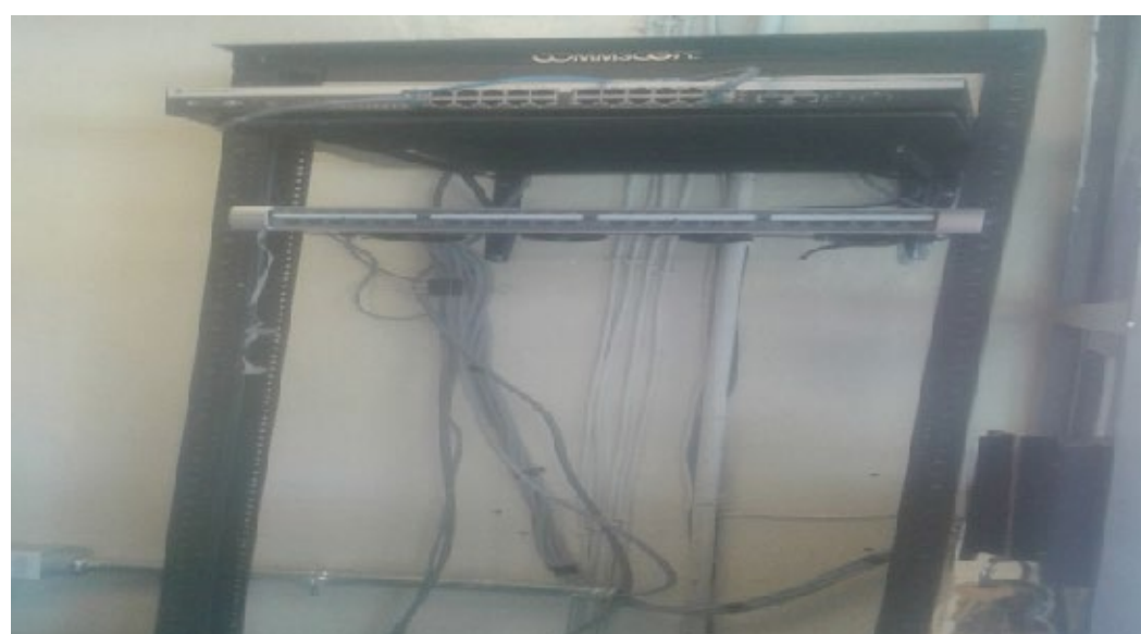
Instalación de rack en el Edificio de Gobierno
