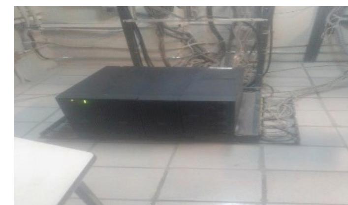
Mantenimiento Preventivo y correctivo de los IDF
