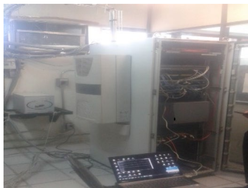
Equipo Patch Panel Site Principal
