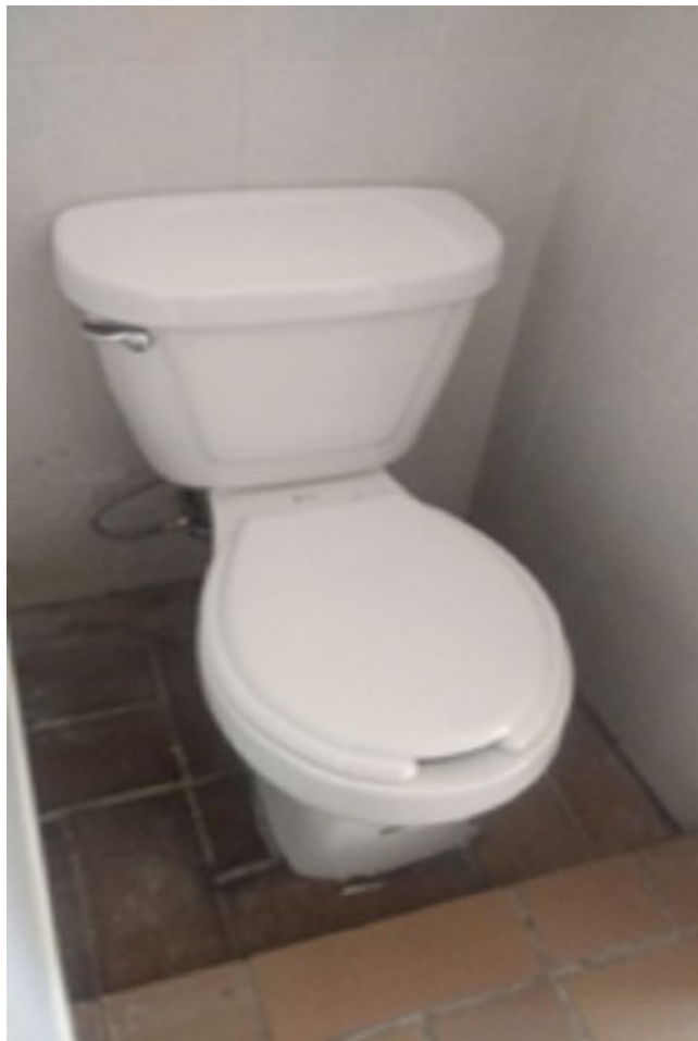
Mantenimiento en muebles sanitarios
