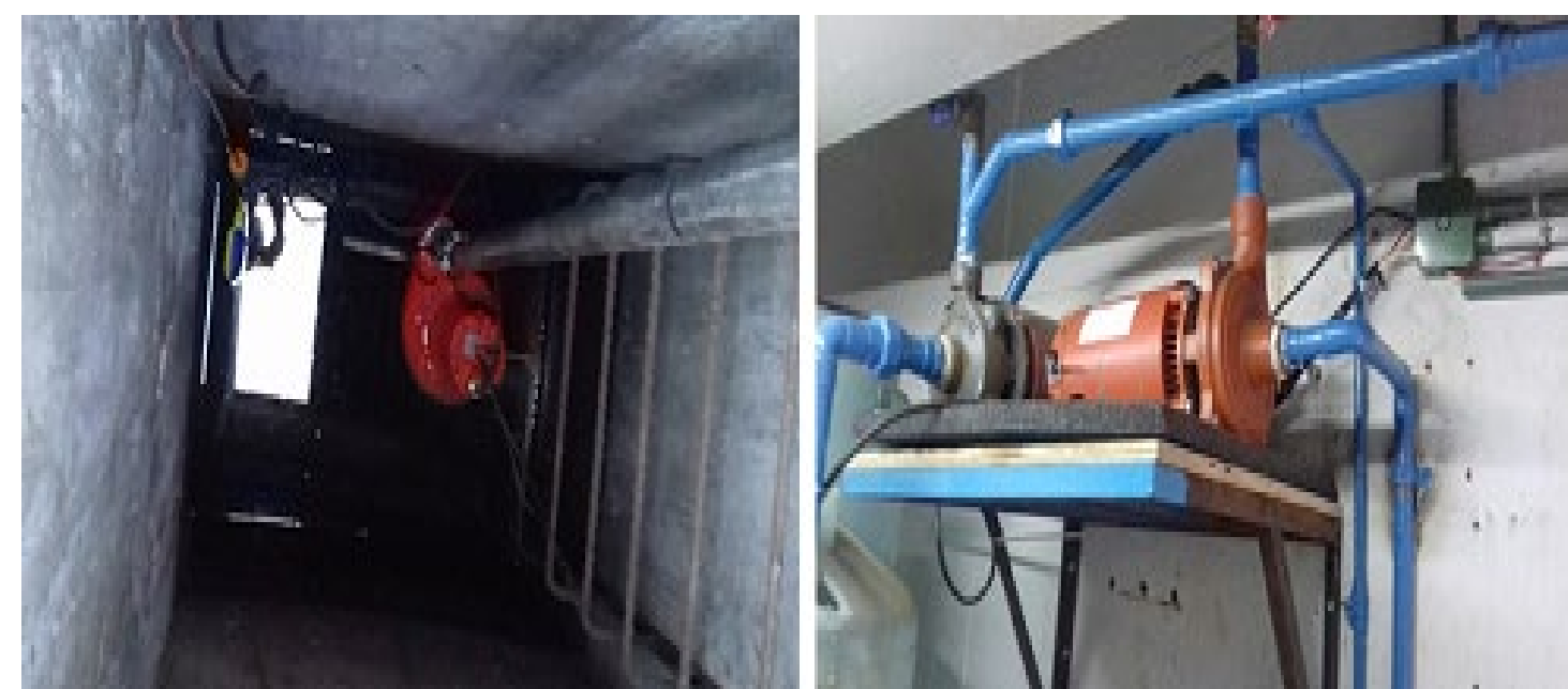
Sistema de bombeo
