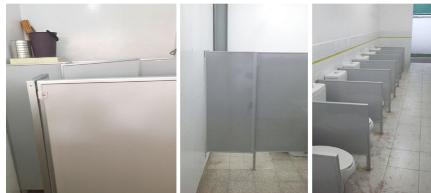
Mamparas en sanitarios
