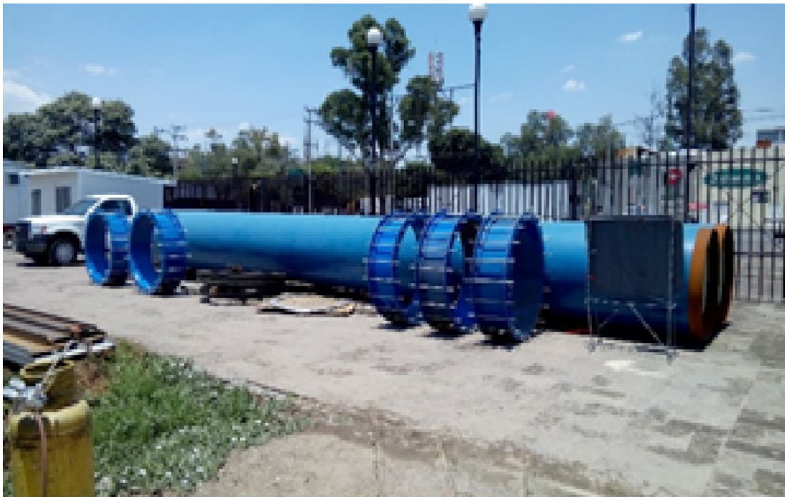
Tubería de agua potable de 48"
