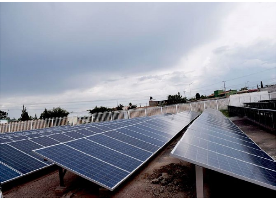
Paneles fotovoltaicos instalados en nuestro Centro
