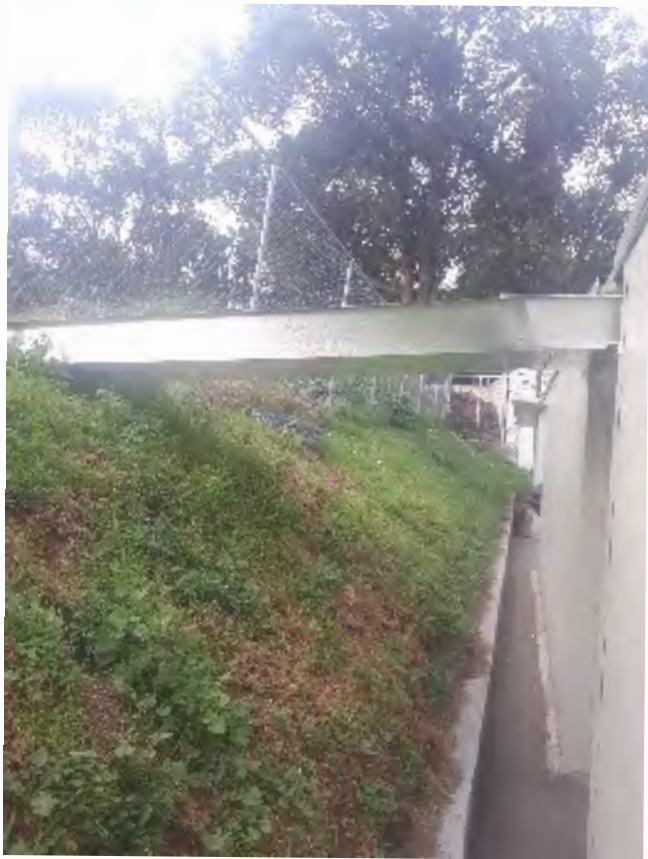
Canaletas instaladas en aulas ubicadas en canchas
