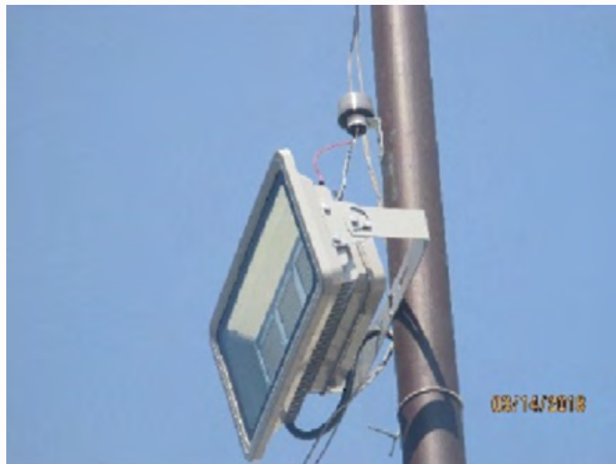
Luminarias instaladas en explanadas y andadores
