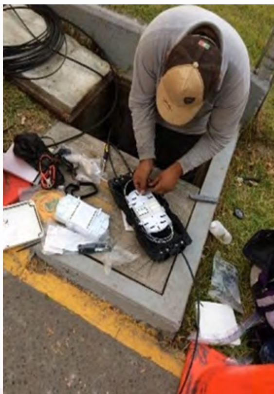
Empalme de Fibra Óptica
