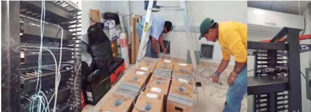
Cableado de Red del Edificio "E" y "D"
