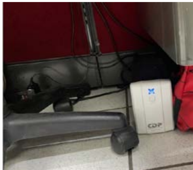
Protección de equipos del centro empleando dispositivos
