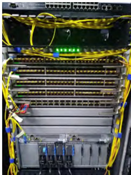
Integración de nuevos equipos de núcleo con la instrumentación de zonas de IPv6 puro
