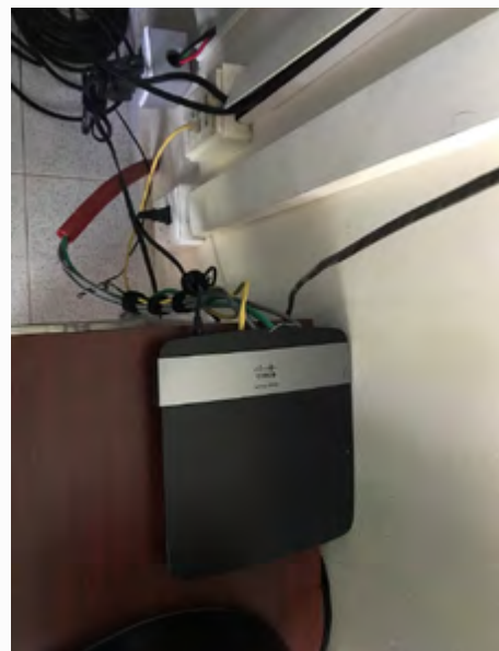
Colocación y Administración de Access Point en el Estadio Wilfrido Massieu
