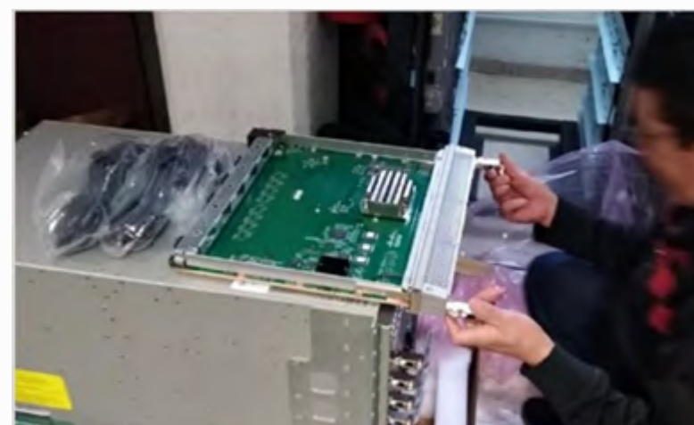
Migración de los equipos de núcleo, constituyendo una delta redundante de 40 GB entre los nodos de Zacatenco, Santo Tomás y UPIICSA
