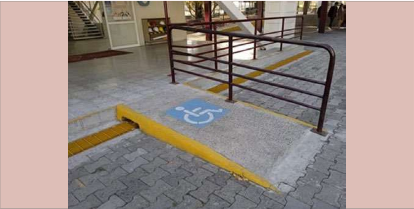
Señalamientos en rampas y accesos en dos edificios.
