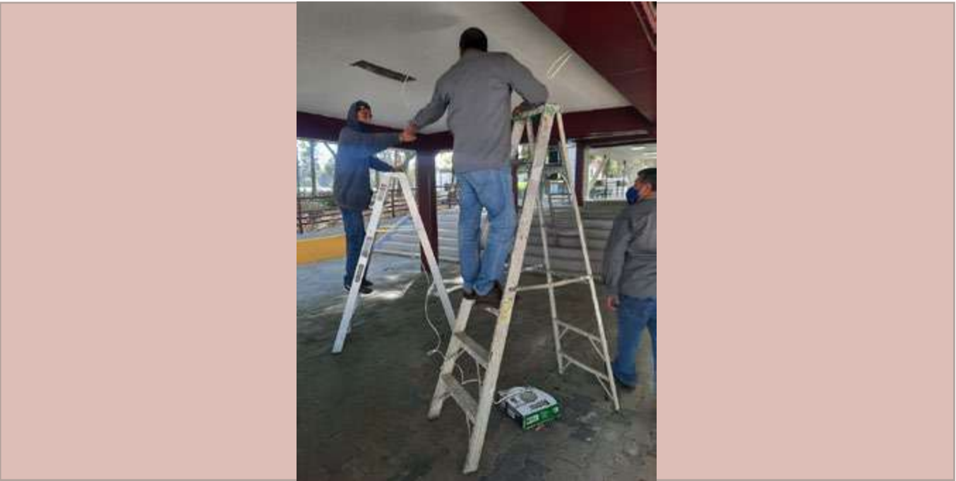
Instalación eléctrica en andador del edificio B al edificio C.
