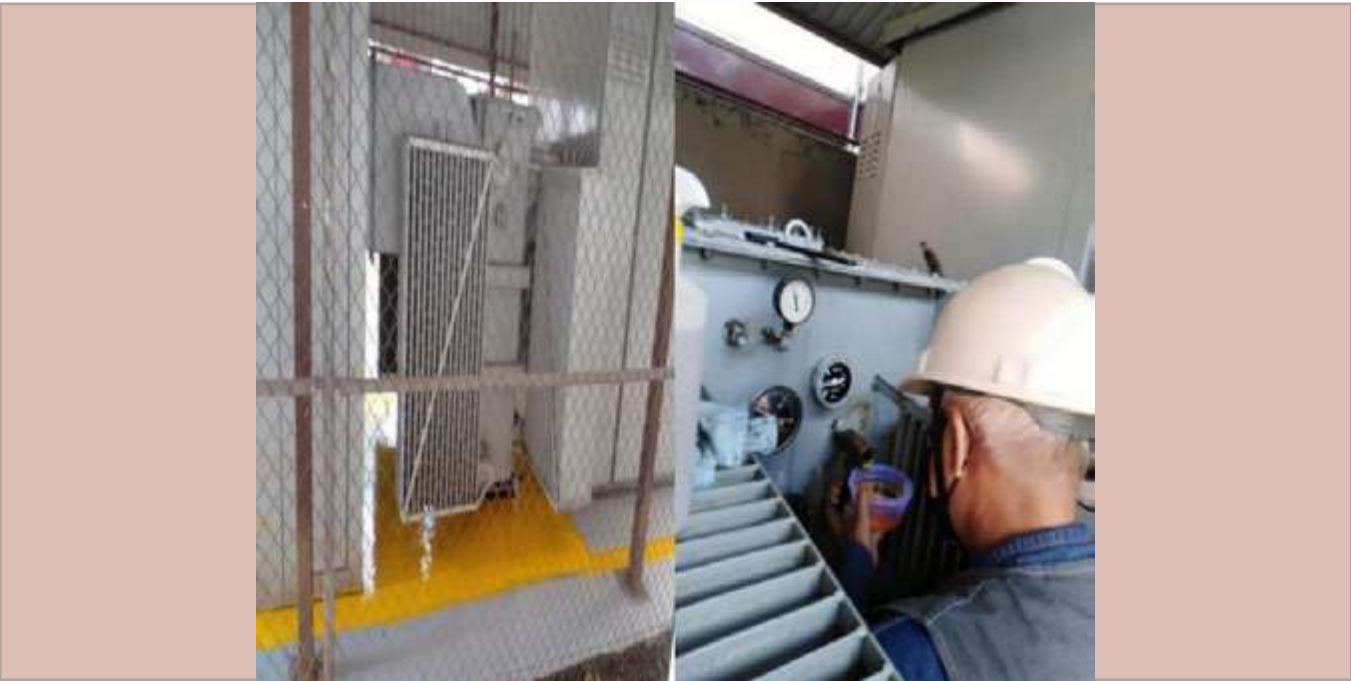
Mantenimiento a subestaciones de la ESCA Unidad Santo Tomás.
