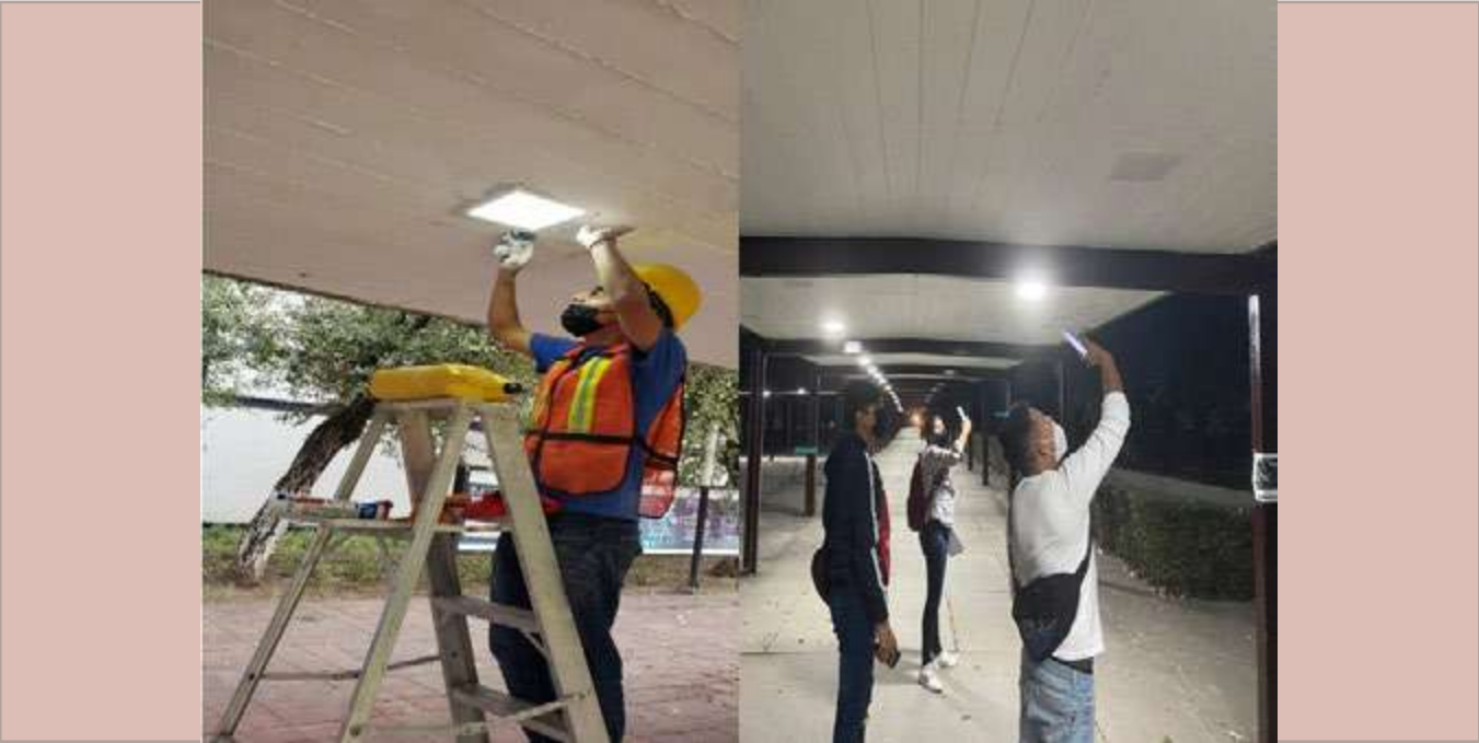
Mantenimiento eléctrico y cambio de luminarias.
