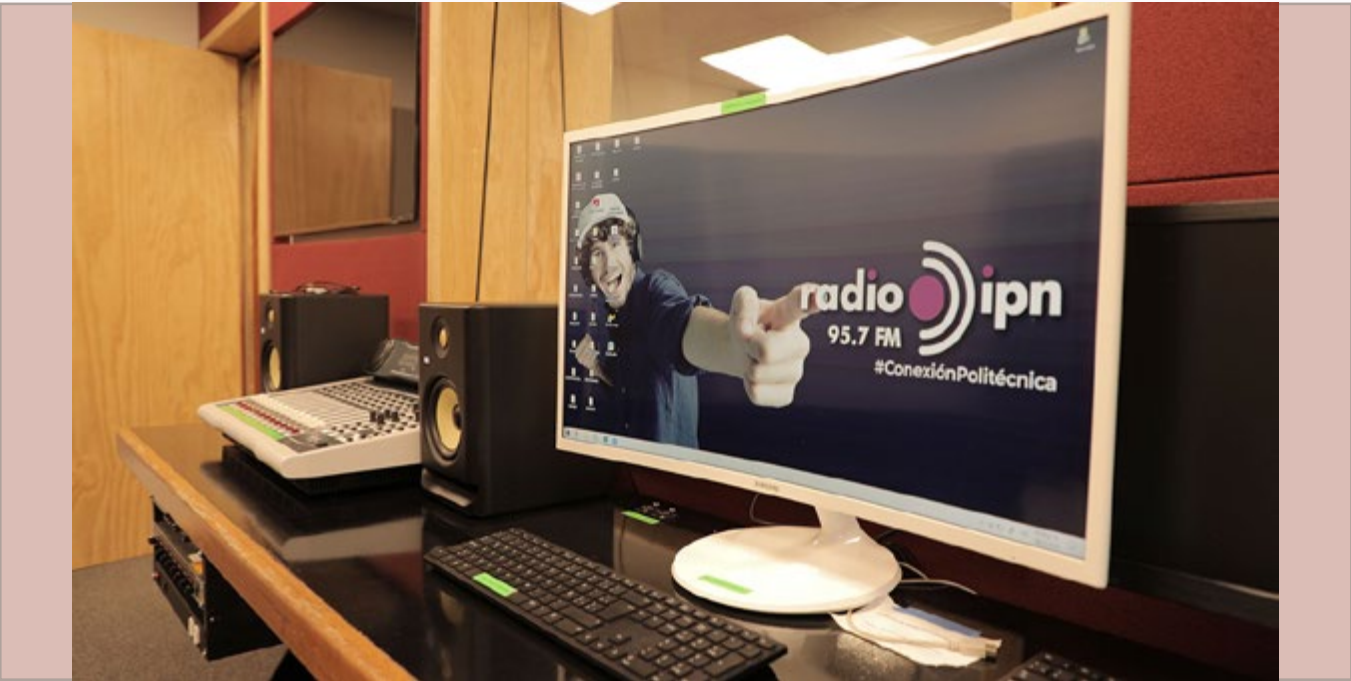
Equipo del estudio de grabación de Radio IPN con sistema de alimentación ininterrumpida (UPS) de 15 kVA.
