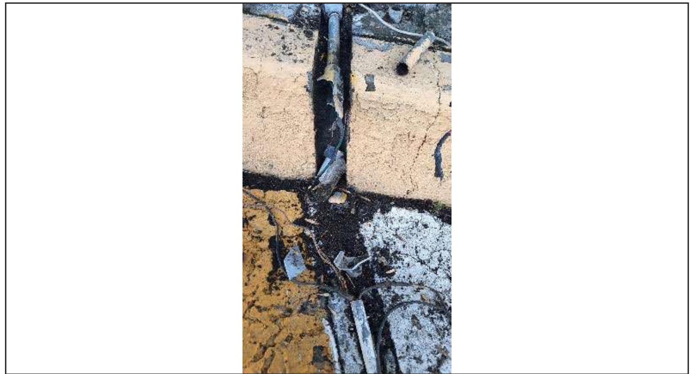
Cable y ductería dañados por corto circuito
