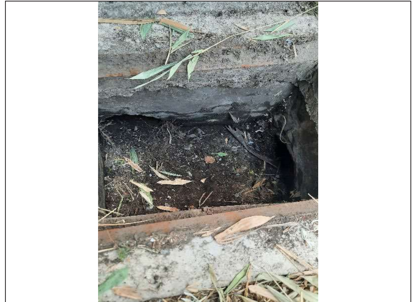
Registro de agua pluvial lleno de tierra antes del desazolve
