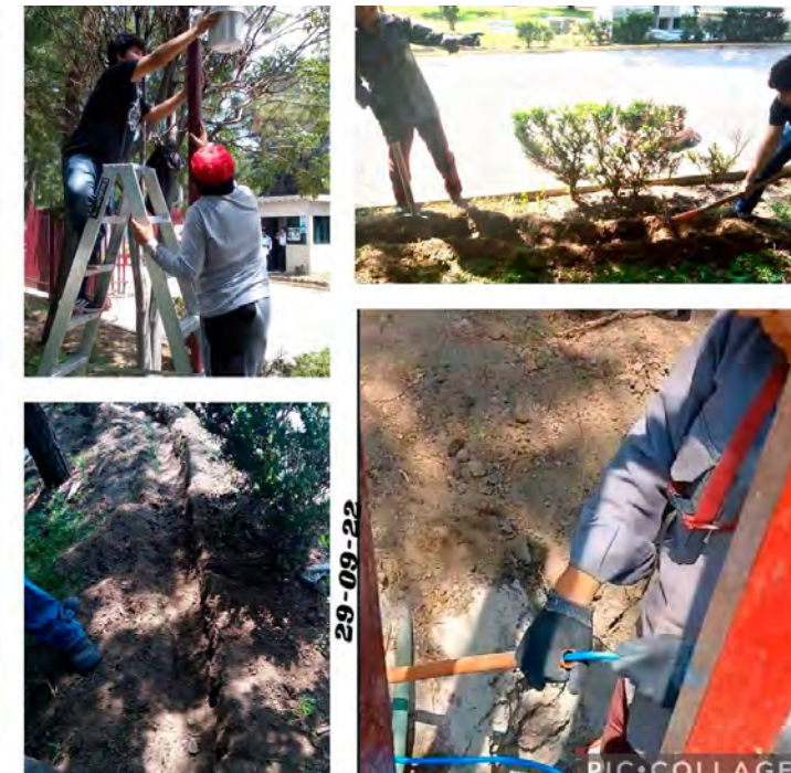
Instalación de un AP en la caseta 2
