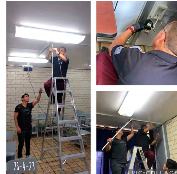
Instalación de videoprojector
