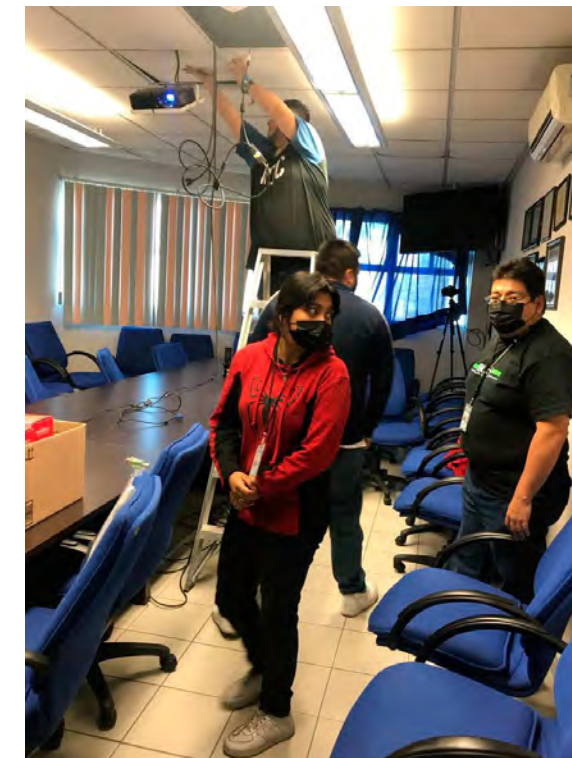
Instalación de equipo de cómputo y cámaras para transmitir reuniones de XXXV CTCE
