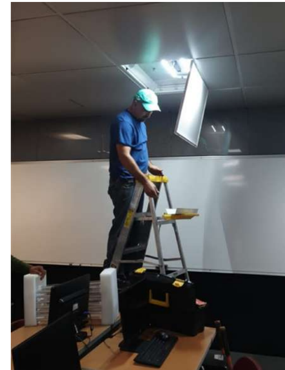
Conversión de luminarias
