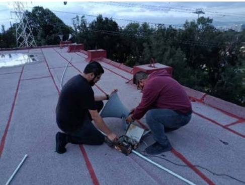
Revisión de sistema de audio de alarma sísmica, septiembre del 2025.
