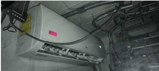
Instalación de un nuevo aire acondicionado en el site principal, julio del 2025.
