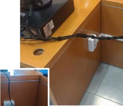
Canalización para cableado HDMI.
