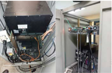
Mantenimiento a sites.
