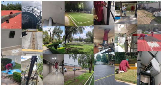
Mantenimiento Preventivo y/o Correctivo Periodo 26/1.
