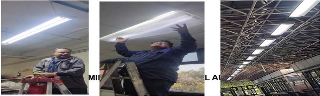
Cambios de luminarias.
