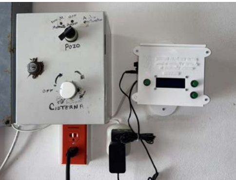
Dosificador de cloro instalado en sitio.
