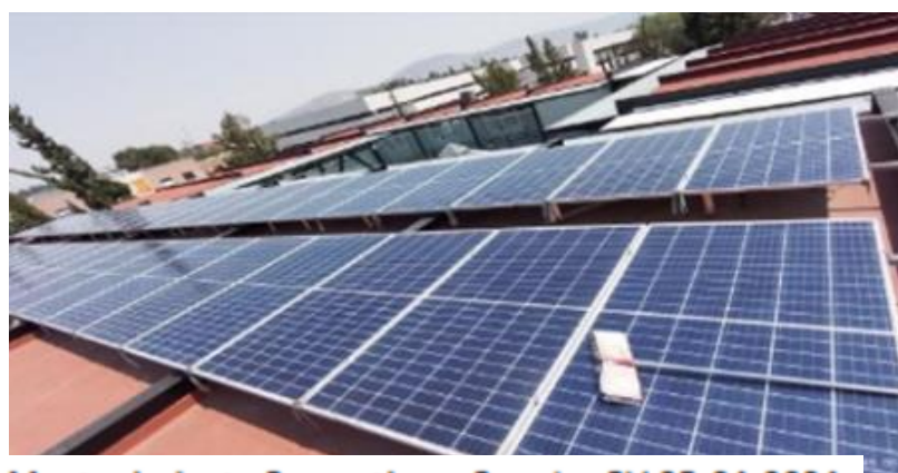
Mantenimiento Preventivo a Paneles PV 25-04-2024
